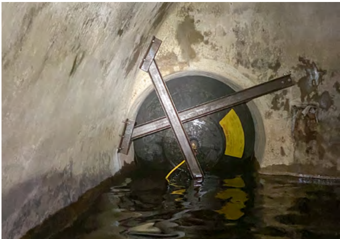
Das ist die eingebaute Gummiblase im Auslasskanal, die mit Stahlträgern verankert wurde. Dadurch konnte vorerst die Überflutung des Kanalsystems verhindert werden. Foto: Stadtentwässerung Dresden
