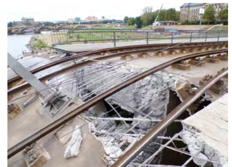
Dieses Bild bot sich am eingestürzten Brückenzug der Carolabrücke. Die Spannstähle hatten aufgrund von Korrosion und Ermüdung versagt. Jetzt soll die Brücke komplett abgerissen und neu gebaut werden. Foto: Stadtverwaltung Dresden
